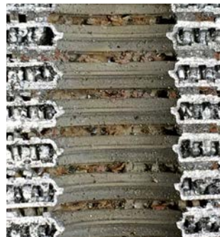
Canal d'amenée contaminé
